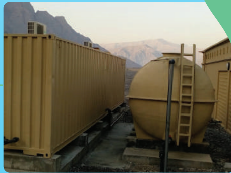
مشروع محطة تحلية مياه في خصب RO plant project in Khasab
