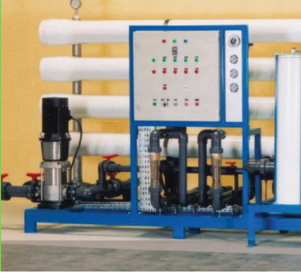
محطة تحلية 100000 جالون / اليوم 100000 GPD RO PLANT
