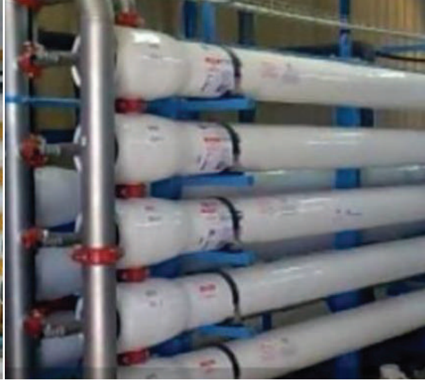
محطة تحلية 150000 جالون / اليوم 150000 GPD RO PLANT
