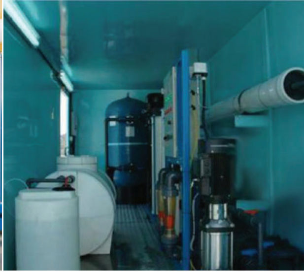
محطة تحلية 20000 جالون / اليوم 20000 GPD RO PLANT
