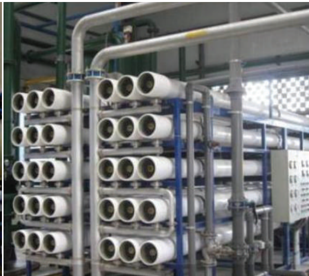
محطة تحلية 700000 جالون / اليوم 700000 GPD RO PLANT
