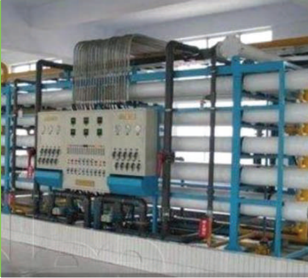
محطة تحلية 300000 جالون / اليوم 300000 GPD RO PLANT
